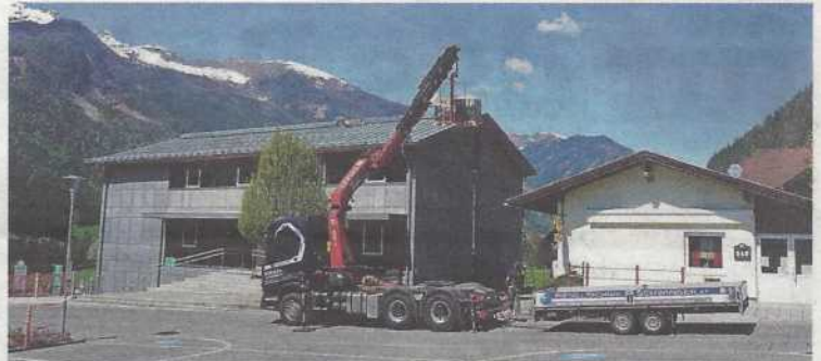
Ein Beispiel für die Projekte: Das Gemeindeamt Malta hat seit Mai 2020 eine Photovoltaikanlage.
