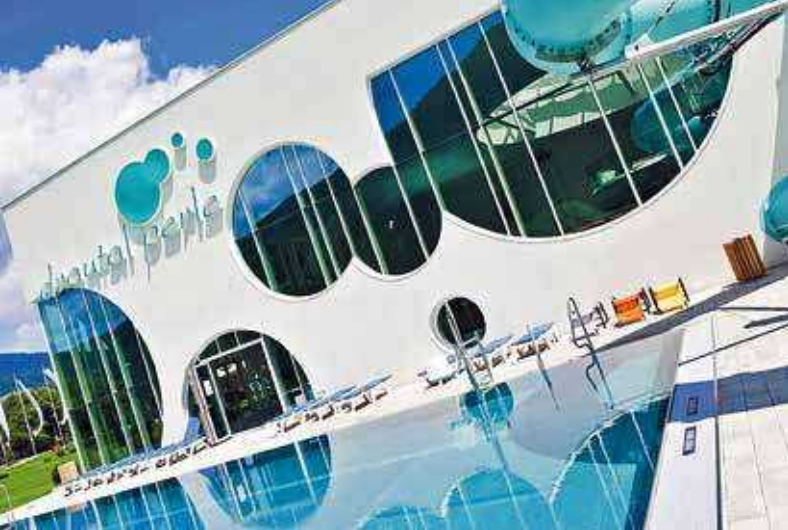
Auf dem Dach der drautal perle errichtet die Stadtgemeinde Spittal ein Sonnenkraftwerk
